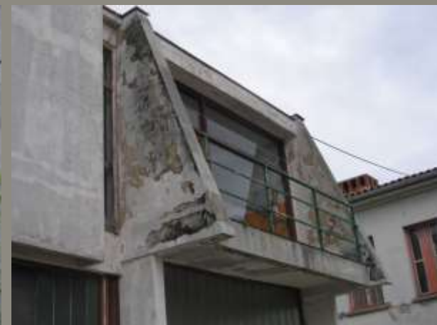
PUKOTINE I LOM KONSTRUKCIJE
